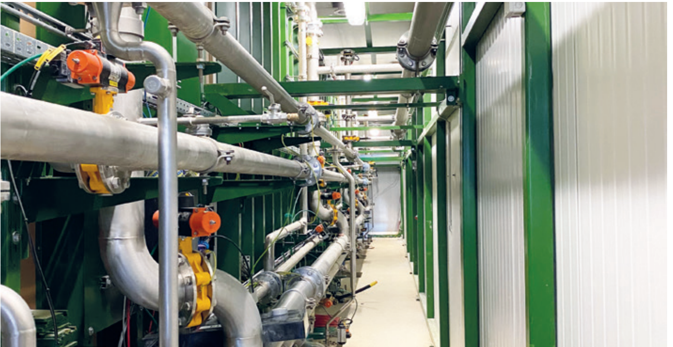
In der Biogasanlage von Kompoferm in Boussens
