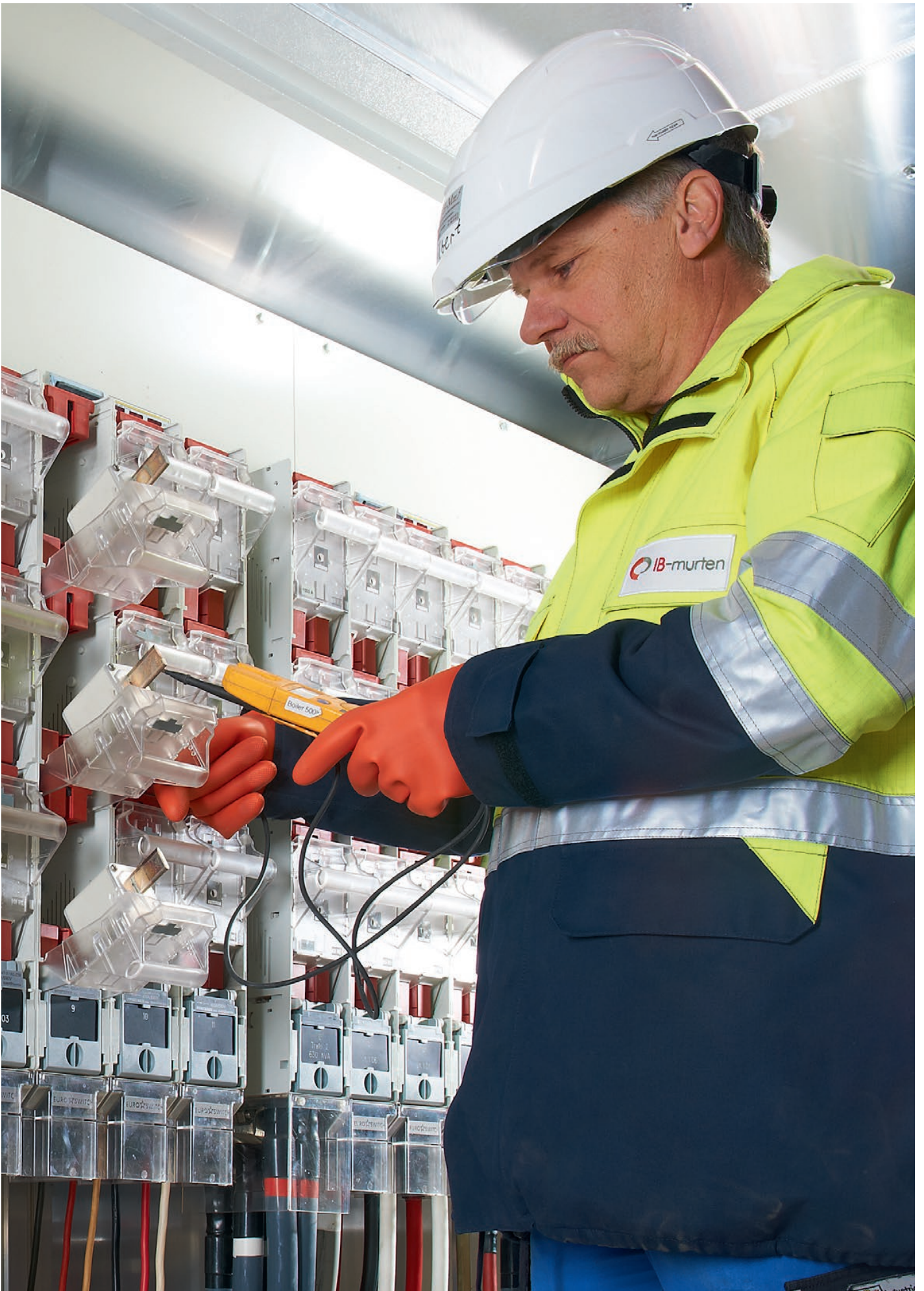
Gilbert Schumacher, Elektroinstallateur, überprüft eine Sicherung der Niederspannungsverteilung der Transformatorstation Schimmelturm, Murten
