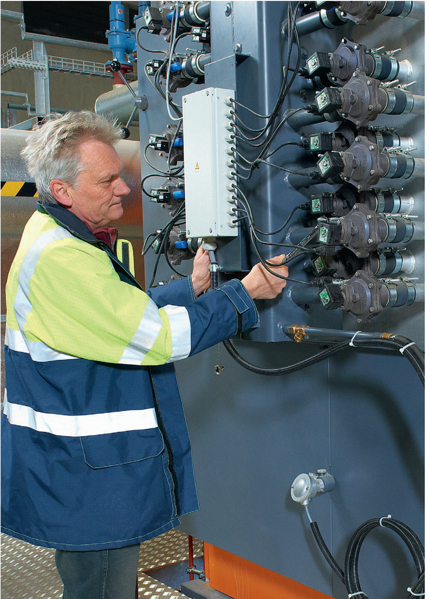
Peter Hunkeler, stellvertretender Betriebsleiter Heizzentrale, überprüft die Druckstossabreinigung in der Heizzentrale
